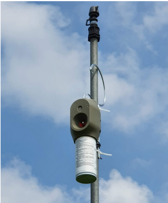
Abb. 3: An einem Überkronenregnerrohr befestigter Aerosol-Dispenser. (Fotos: Rolf Hornig)
