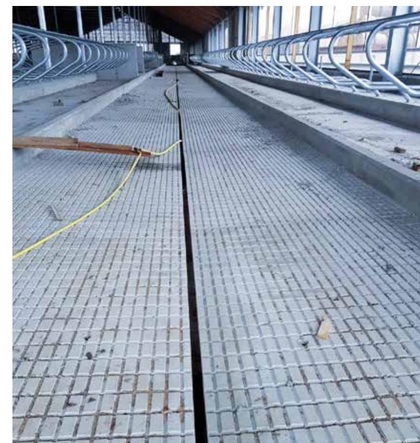
Emissionsreduzierender Betonfußboden mit 7 % Gefälle
