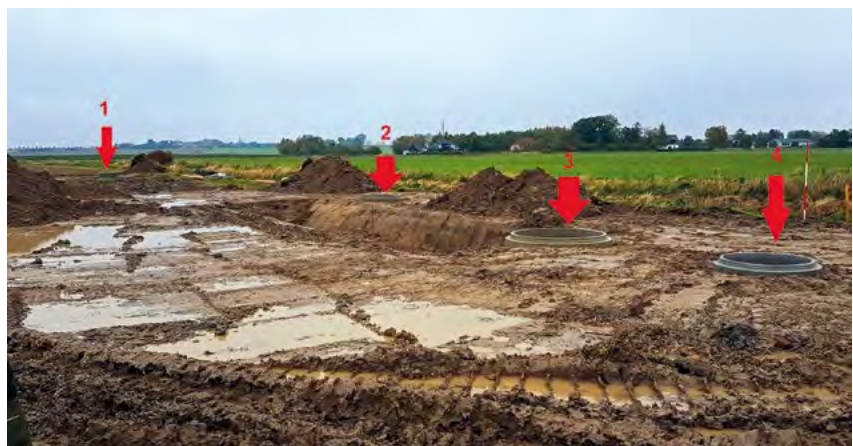
Abb. 2.: Übersicht der gesetzten Revisions- und Messschächte
